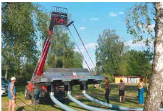
Aktueller Einbau im Mai 2018 in Markt Ebensfeld 4-SN
